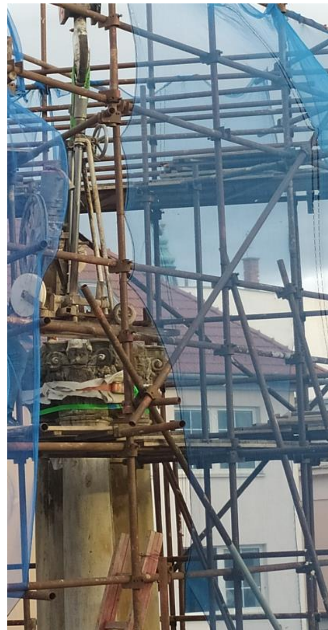
Závazným stanoviskem bylo schváleno kotvení hlavice do dřívku sloupu Nejsvětější Trojice
