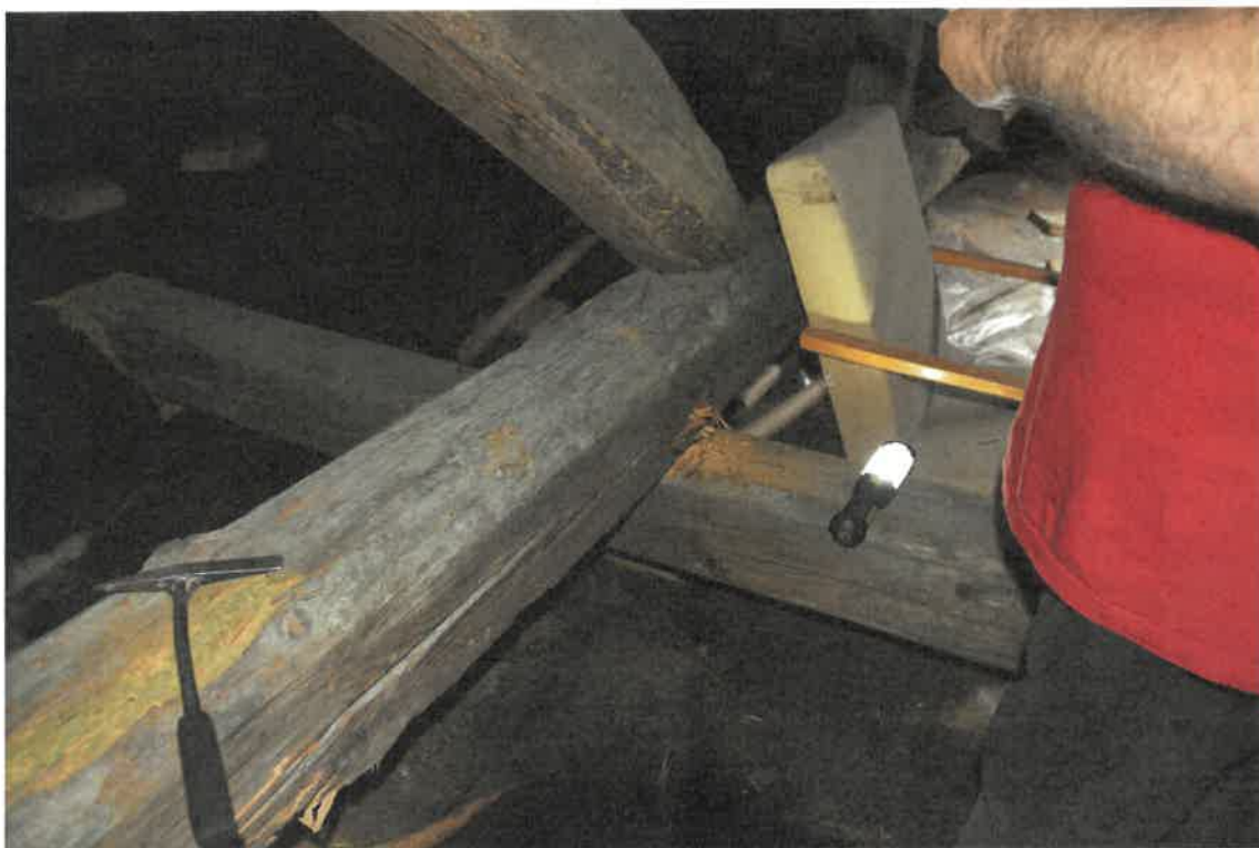
Poškozené části krovu
