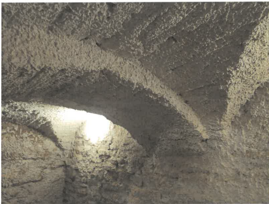
Fotografie před a po provedení sanačních prací - po otlučení omítek v roce 2021 Chlapecký zpěvácký seminář, ul. Jánská 27/10, na pozemku st. p. č. 246 v katastrálním území Kroměříž, rejstříkové číslo kulturní památky č. ÚSKP 41560/7-6009
